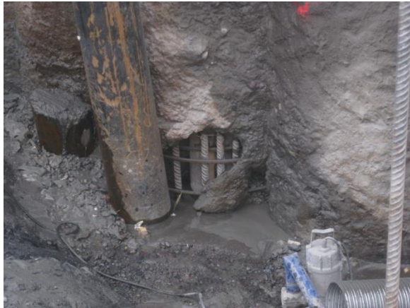
Bild 23: Schlecht eingebundener Bohrpfehl mit Not-Dübel
