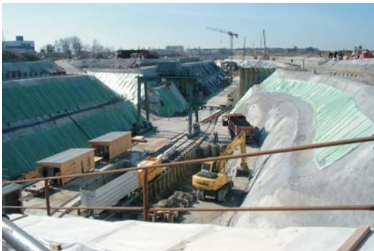
Herstellung der U-Bahn-Röhre in einer offenen, geböschten Baugrube außerhalb der innerstädtischen Bebauung
