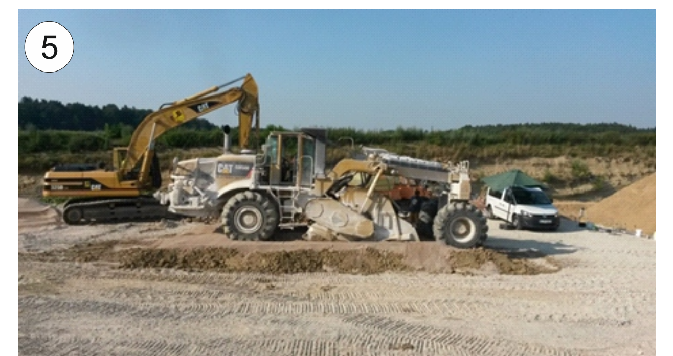
Bodenfräse beim Untermischen von RC-Mix Q/4 zu feinkörnigen Boden zur Bodenverbesserung soil miller mixing RC-Mix 0/4 with fine-grained soil for soil improvement
