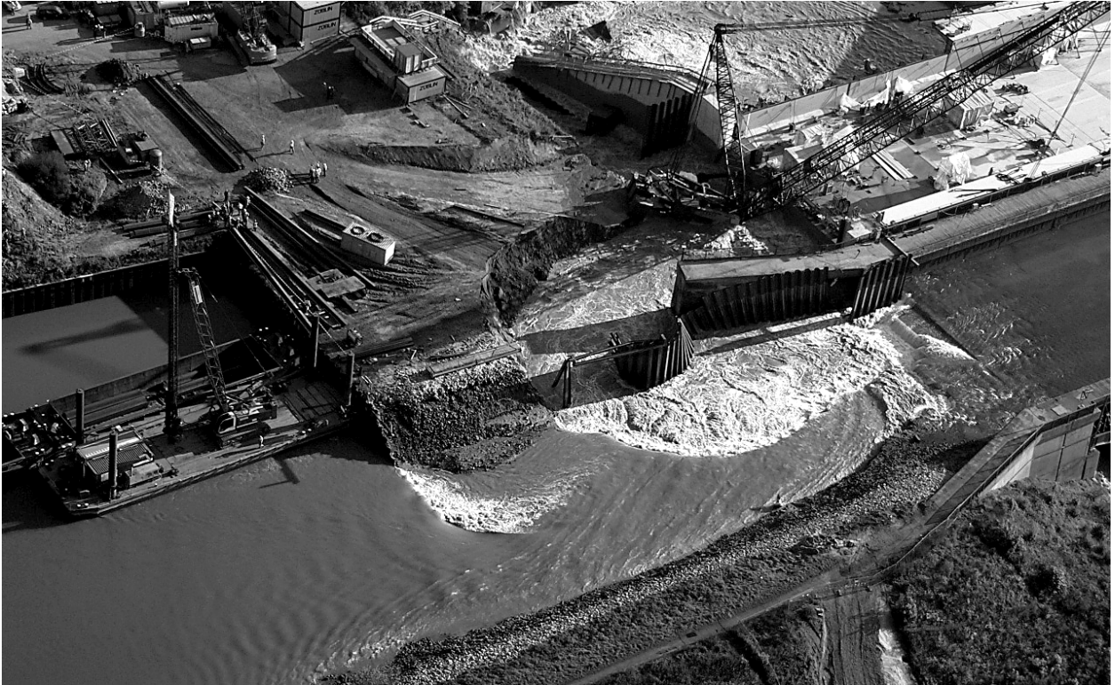
Bild 6: Luftbild vom gebrochenen Damm neben der unterströmten Flügelwand
