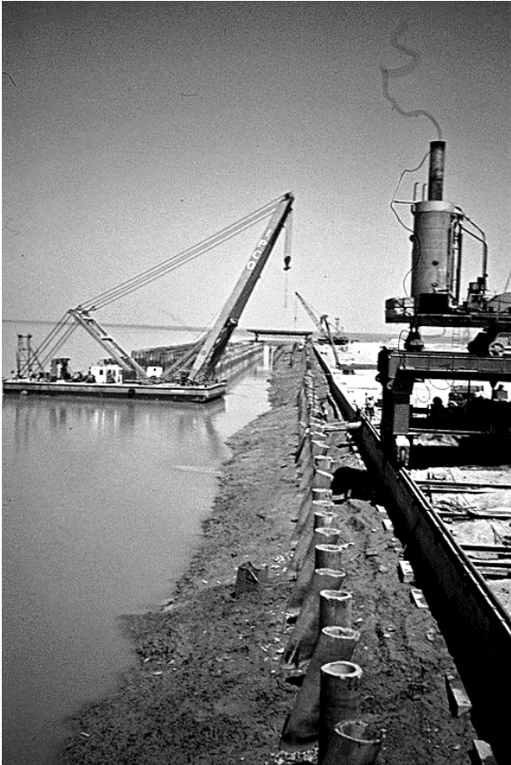
Bild 21: Ausbauchung an der Stützwand infolge der Installation der Landseitigen Spannbetonpfahlreihe
