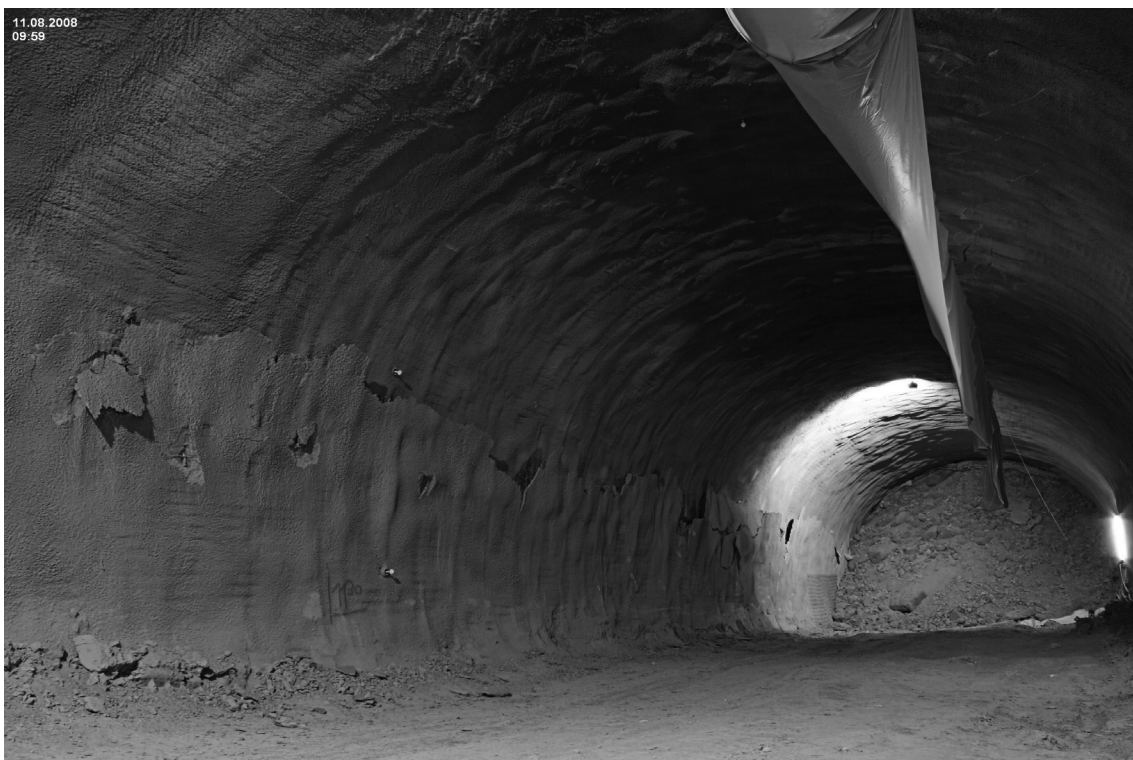
Bild 3: Rissbildungen in der Spritzbetonschale nach dem ersten Verbruch
