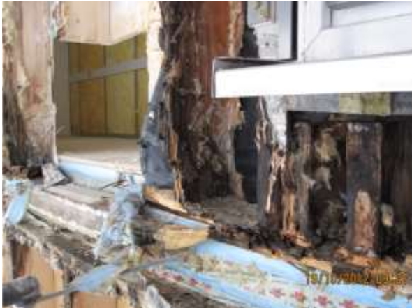
Abb. 1 Feuchteschaden an Außenwand durch undichten Fensterbankanschluss
