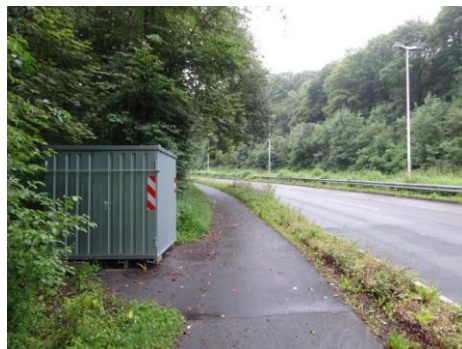
Abb. 19: Standort einer Behandlungsanlage in Wuppertal
