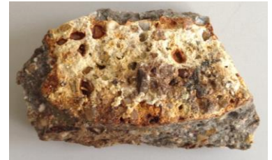
Abb. 25: Durch BSK verursachte Betonschäden
