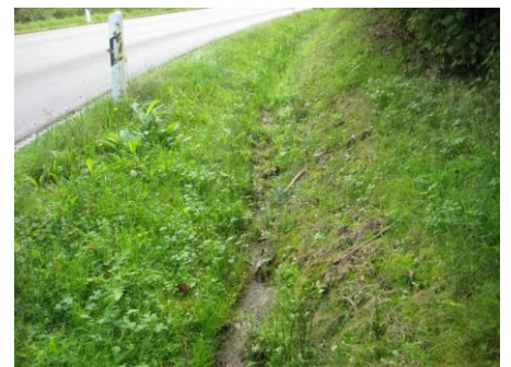
Abb. 17: Versickerungsmulde für Straßenabflüsse
