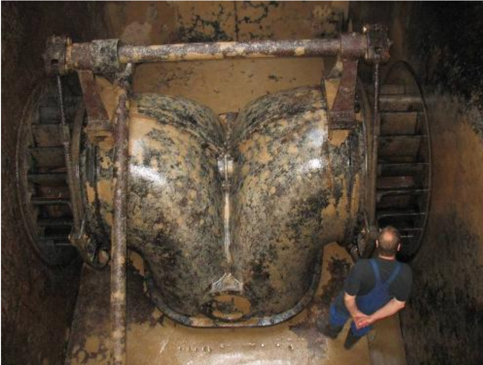
Blick auf eine Zwillingsturbine
