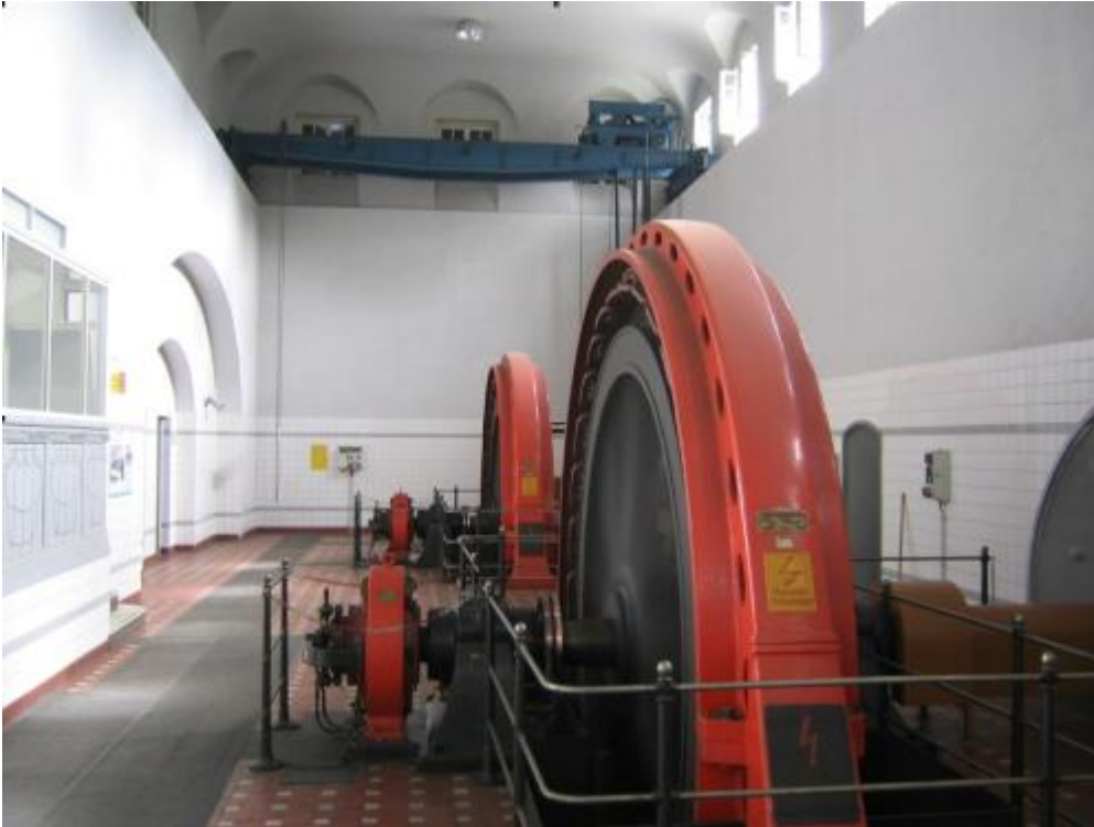
Blick ins Krafthaus mit Generatoren
