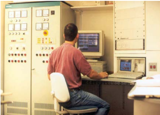
Steuerung und Messwerterfassung
