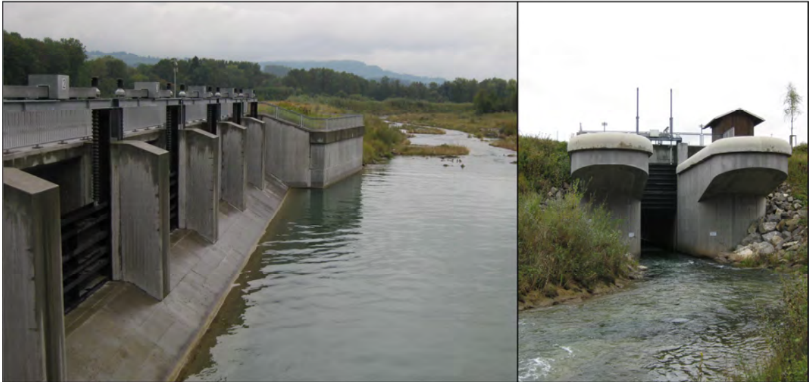
Abbildung II - 28: Einlaufbauwerk (links) und Auslassbauwerk (rechts) des Flutpolders Weidachwiesen an der Iller.
