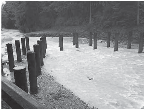
Abb. 2.4: Beispiel eines doppelreihigen V-förmigen Schwemmholtzrechens (Lainbach, Oberbayern, Foto Asenkerschbaumer)
