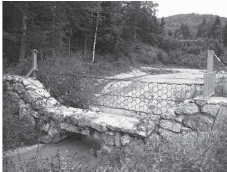
Abb. 2.33: Seilnetzsperrung über Geschiebesperre (Kranzbach, Oberbayern, Foto: Asenkerschbaumer)
