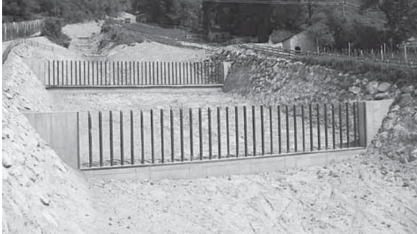
Abb. 2.1: Beispiel für Schwemmholzrechen mit einer Anordnung senkrecht zur Fließrichtung (Galsauerbach, Südtirol, Foto Asenkerschbaumer)
