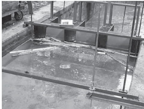
Abb. 3.15: Verklausung bei drei teilgeöffneten Wehrfeldern
