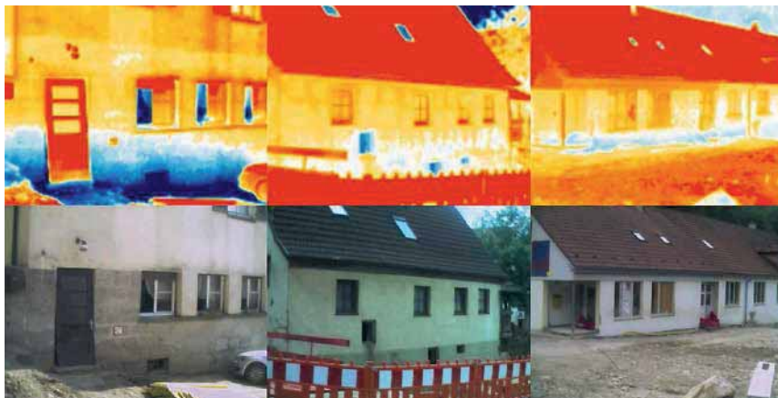
Abb. 7 Wärmebildaufnahmen (oben) und RGB-Normalaufnahmen (unten) von betroffenen Gebäuden zur Abschätzung des Wasserstands und zur Identifikation der Bausubstanz (z.B. Mitte: verputztes Fachwerk). Aufnahmen vom 08.06.2016 (Jonas Laudan, Universität Potsdam).
