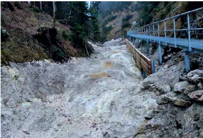
Abb. 10 Sicherung des Steges gegen Verklauung durch eine Gleitwand
