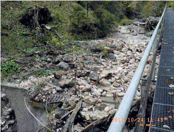
Abb. 9 Verklauungsgefährdeter Steg vor Umsetzung der Maßnahmen
