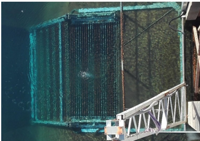
Abb. 6: Verwendung des Fixed FishProtector (Stahlrahmen mit 8 mm Stahlseilen als Elektroden bespannt) am Einlaufbauwerk eines Pumpspeicherkraftwerks in Südtirol.
