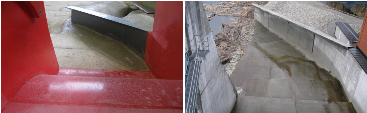
Abb. 9 Optimierte Lösung mit der schrägen, überdachten Leitwand im Unterwasser des zusätzlichen vierten Wehrfelds in Modell und Original
