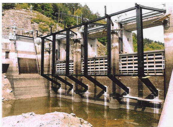
Abb. 6 Vorgelagerter Schwemmholzrechen am Thurnbergspeicher am Kamp in Österreich (Foto: Bundesministerium für Land- und Forstwirtschaft, Umwelt und Wasserwirtschaft, A).
