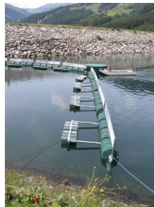
Abb. 8 Schwimmrechen (Foto: H. Czerny, Bundesministerium für Land- und Forstwirtschaft, Umwelt und Wasserwirtschaft, A)
