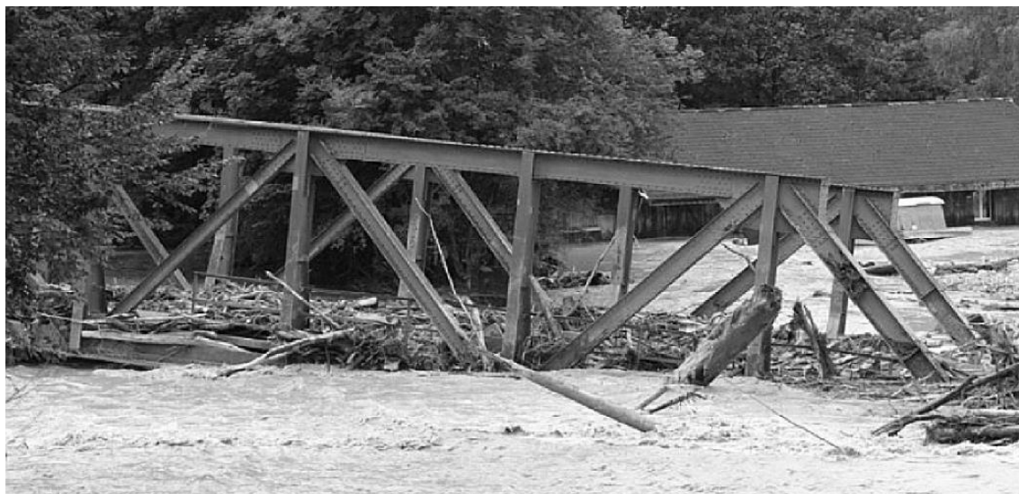
Abb. 1 Verklauung der Eisenbahnbrücke Sarnen, Kanton OW (Quelle: Tiefbauamt Kanton OW 2005).
