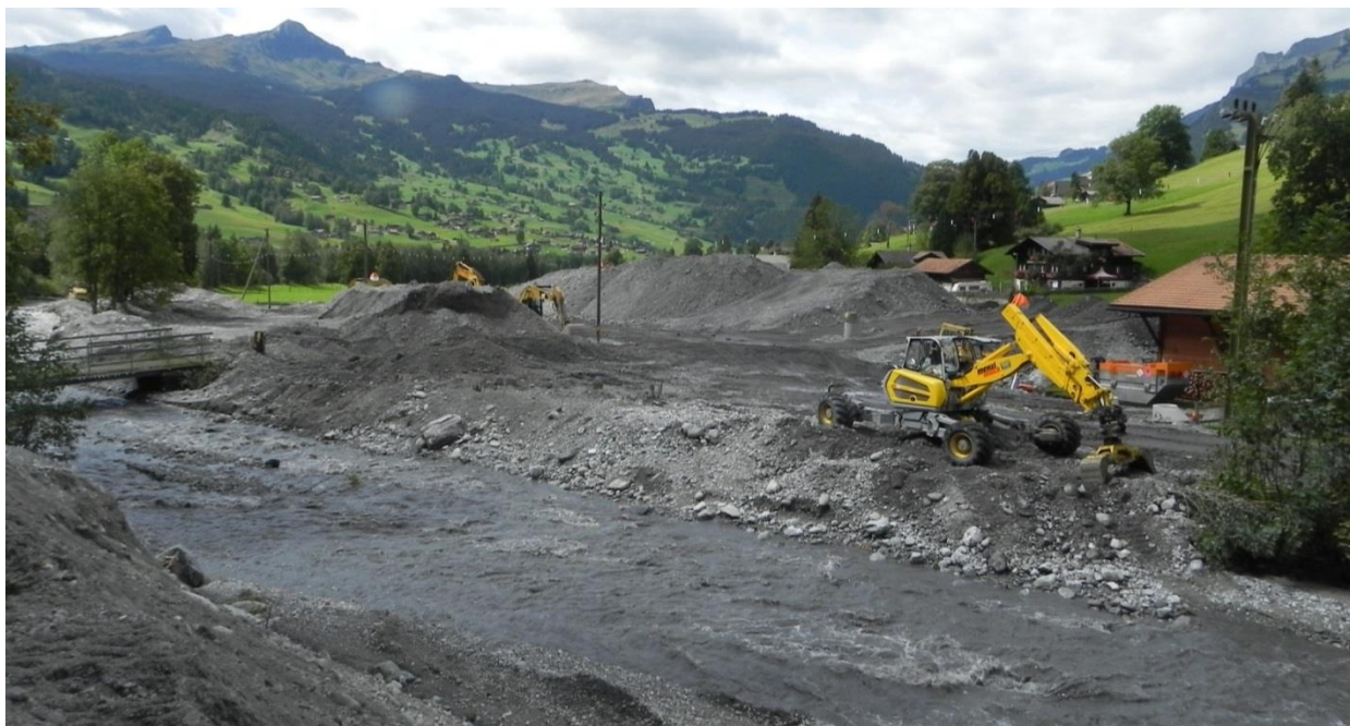
Abb. 2 Geschiebeentnahmen an der Schwarzen Lüttschine im Bereich Mättenbergbrücke in Grindelwald nach den Flutwellen im Jahr 2011 (Foto: Nils Hählen).
