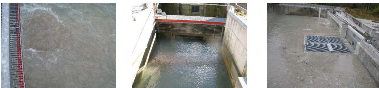
Abb. 12 Turbulenz am Saugschlauchende (li.), Ablagerung nach Durchgangsdrehzahl am Saugschlauchende (mi.) und im Einlauf (re.)
