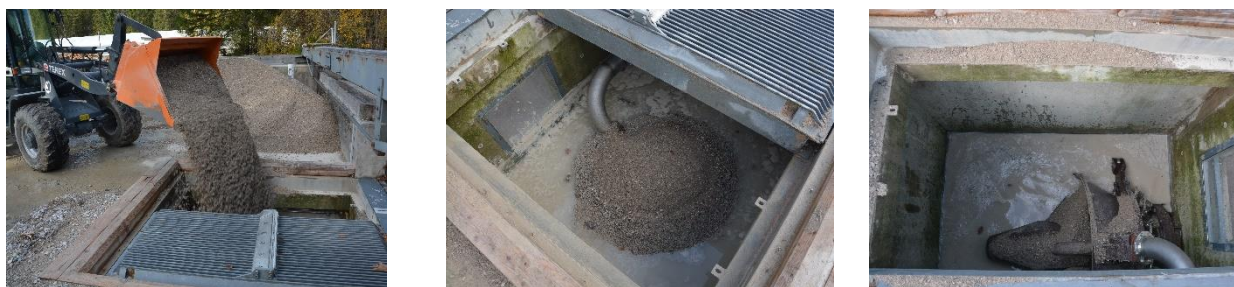
Abb. 8 Geschiebespülung mit Unterstützung der Rechenreinigung
